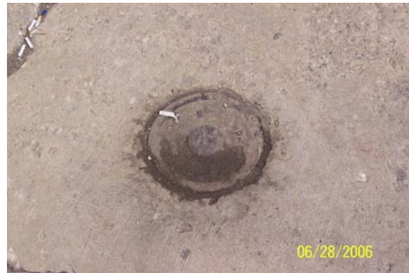
DT 50 – UST Fill Port
