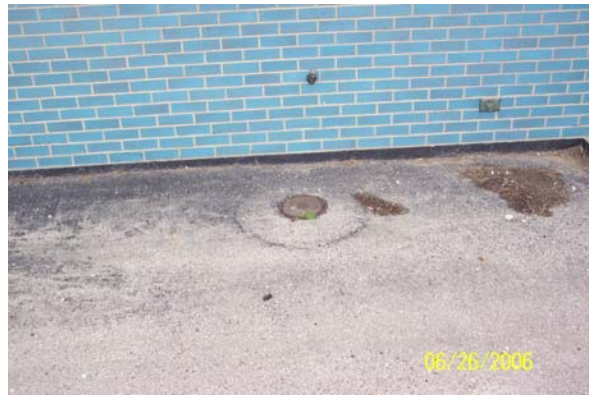
NC 20A – UST Fill Pipe
